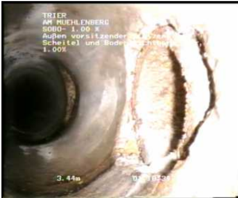
häufiges Schadensbild im Kanalnetz Trier-Kernscheid
